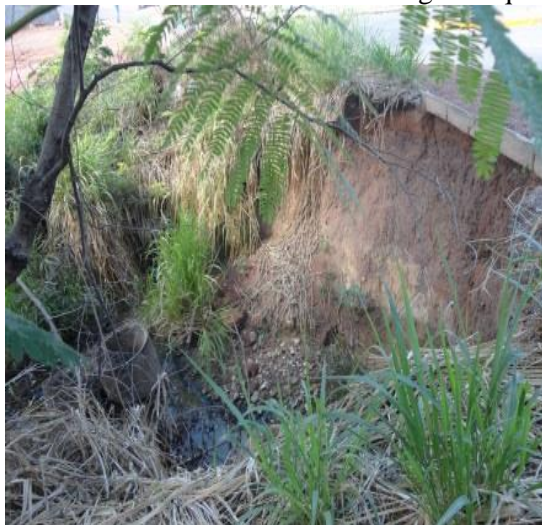
Figura 2: Erosão e assoreamento no Córrego Chiquinha.
